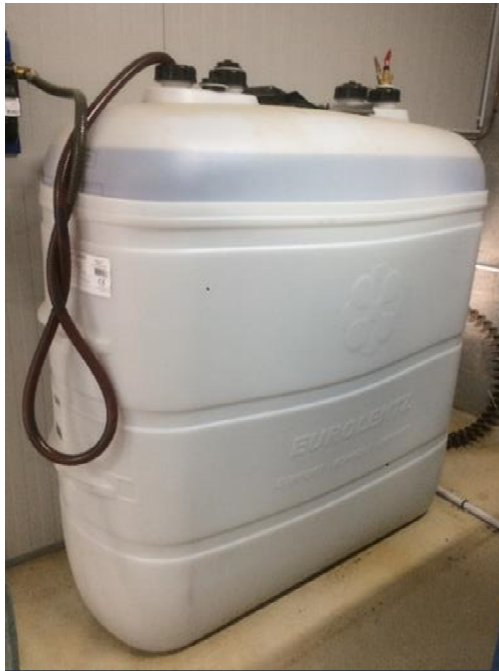
Figure 38 : Cuve à fioul à double paroi de l'élevage
