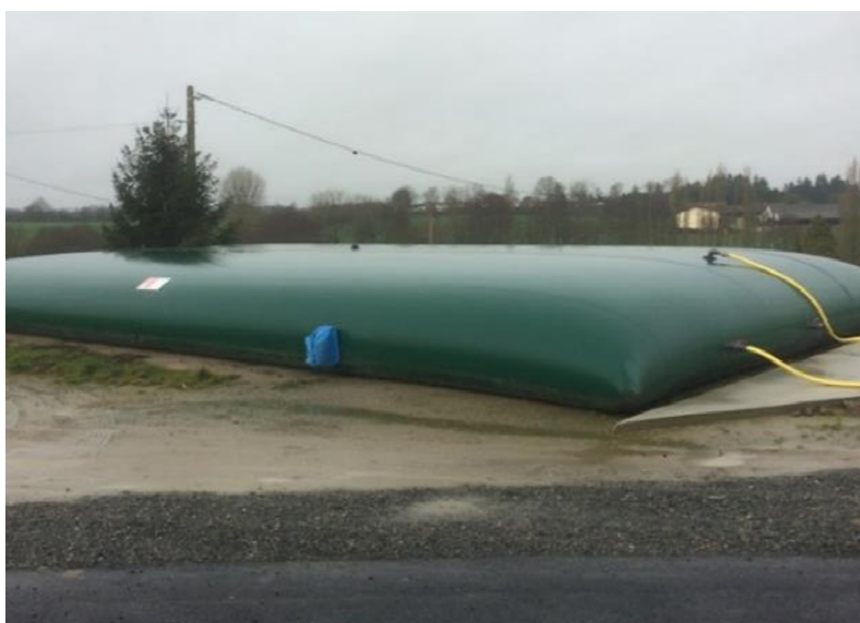
Figure 45 : Réserve incendie de 240 m 3 présente sur site
