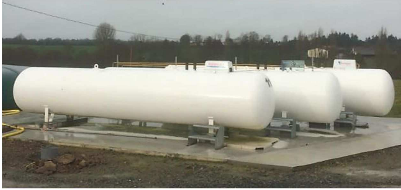
Figure 39 : Citerne à gaz alimentant le site d'élevage
